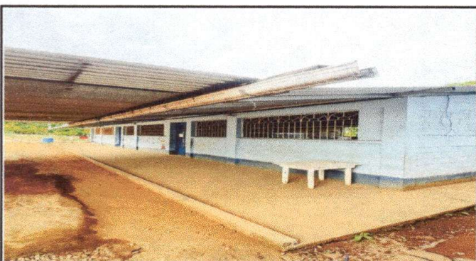
Foto 3: Sustrucción de canal de metal
